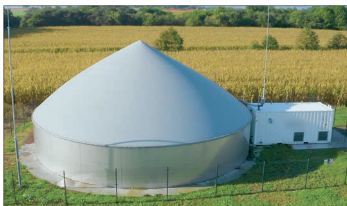
Mikrobiogazownia rolnicza w gospodarstwie rolnym w Starczowie, należącym do Ośrodka Hodowli Zarodowej w Kamieńcu Żąbkowskim
